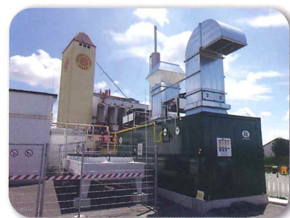
水素発電設備設置例 (ドイツ)
